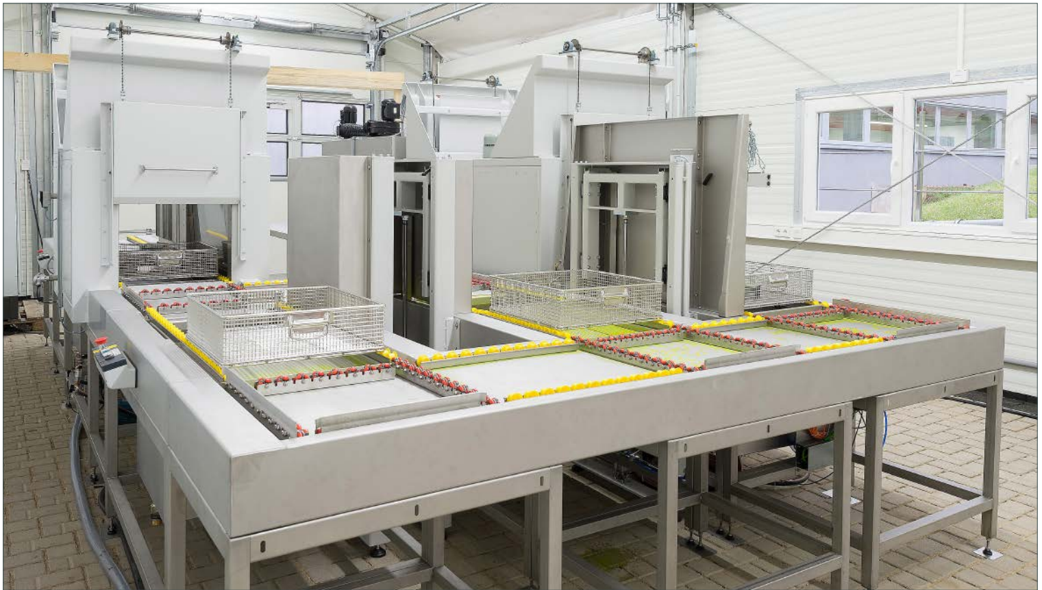
Halbautomatische Prüfanlage mit Vorreinigung und zwei Tauchbecken für Prüfmittel mit unterschiedlicher Empfindlichkeit
