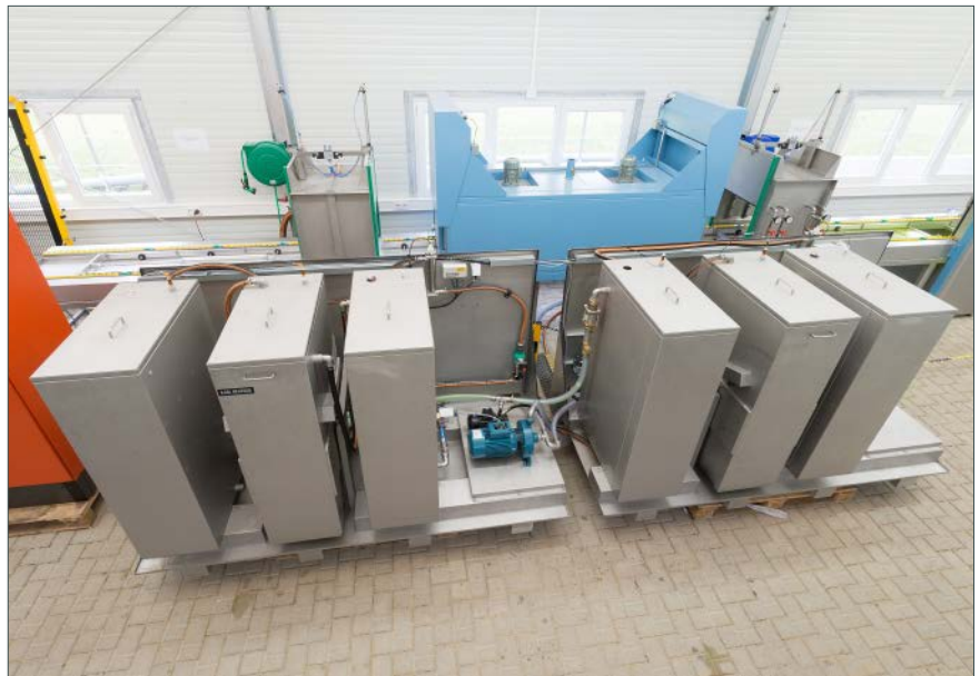
Kreislaufführung des Waschwassers: Regenerierung mit Aktivkohle über doppelte Kolonne
