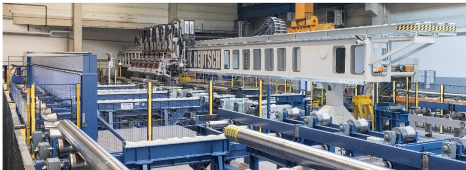
Abb. 12. Prüfbrücke für Stabstahl bei der BGH-Siegen Edelstahl GmbH. Die Beladung erfolgt von rechts (Stab-Quertransport unterhalb der weißen Prüfbrücke per Hubbalken). Die Rollgänge für die Sortierung und die Station für die Nacharbeit sind links zu sehen.
