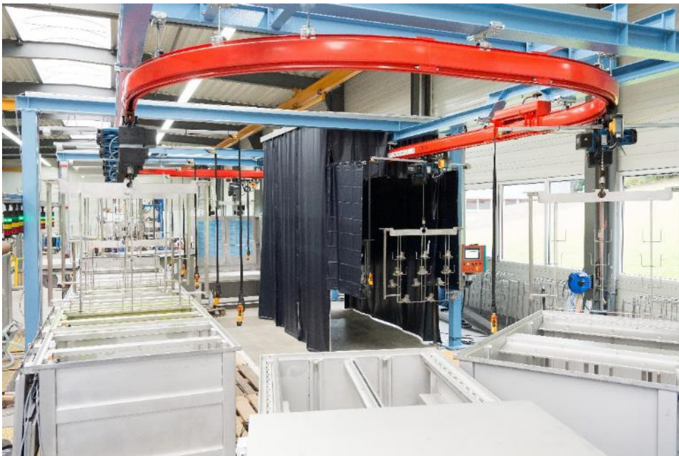
Abb. 8. Gesamtansicht einer halbautomatischen KD-Check-Prüfanlage mit ovaler Kranbahn (die Original-Prüfteile dürfen nicht gezeigt werden).
