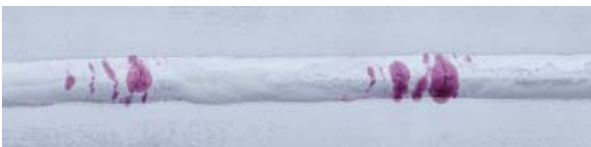
Abb. 11: Rissige Schweißnaht, mit Farbeindringmittel geprüft.
