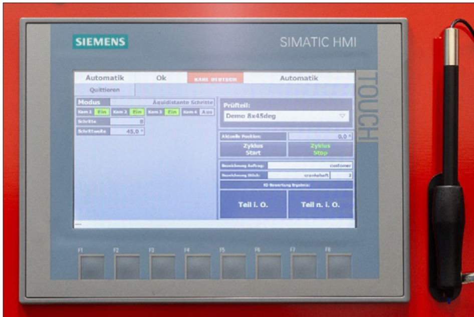
SIMATIC HMI Touchscreen zur Steuerung des Prüfablaufs
