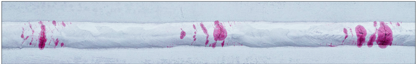
Rissanzeige mit rotem Farbeindringmittel auf einer Schweißnaht
